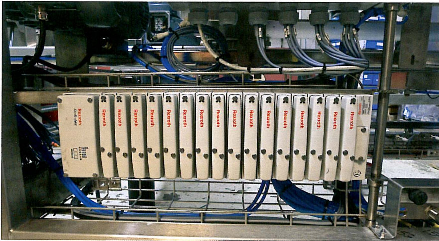
Das Rexroth-Ventilträgersystem CL03 setzt AMC in allen seinen Verpackungslinien ein, um Schaltschränke und lange Leitungen einzusparen.
